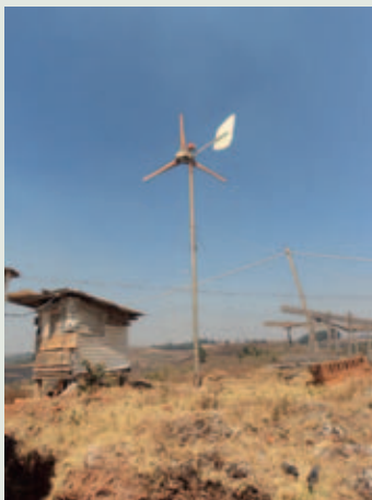
Figura 8. Aerogenerador existente en la granja
