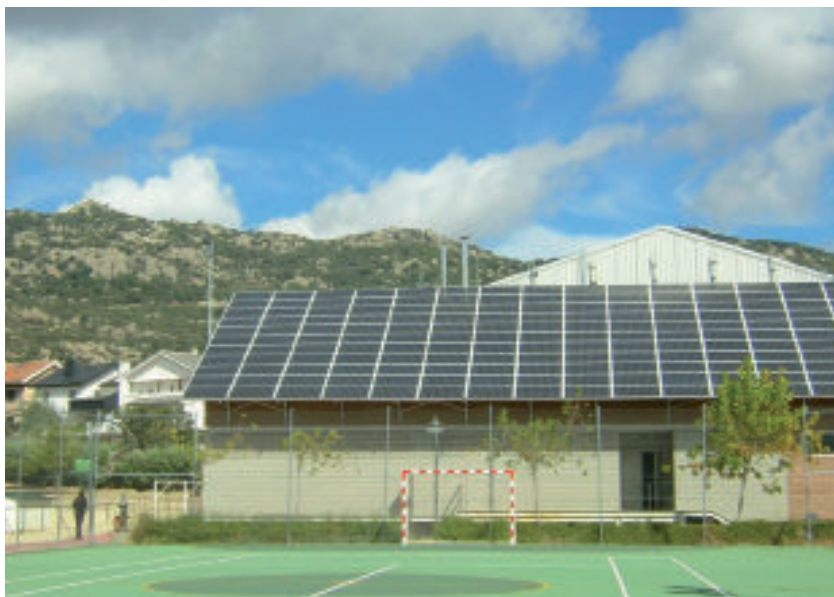
Generación Fotovoltaica sobre cubierta conectada a red.
