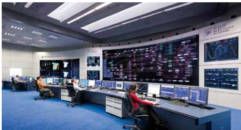
Red Eléctrica de España. Centro de Control y CECRE.
