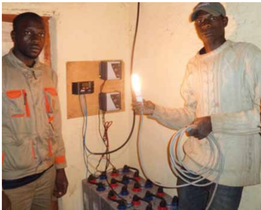
Baterías (12 x 2V), regulador y dos inversores en la escuela cristiana de Bambdzeng
