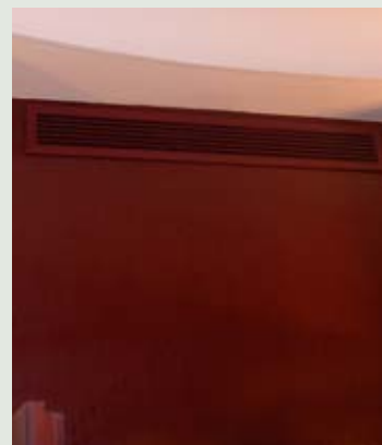
Figura 14. Impulsión del sistema de climatización
