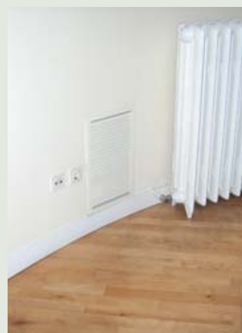
Figura 15. Retorno del sistema de climatización
