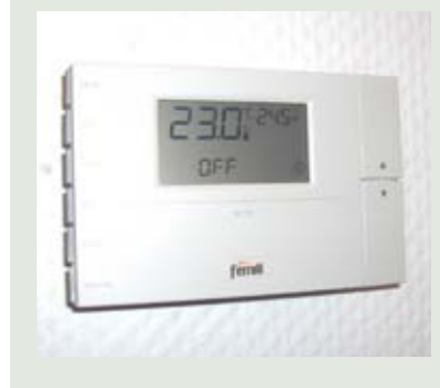
Figura 13. Regulador del sistema de climatización
