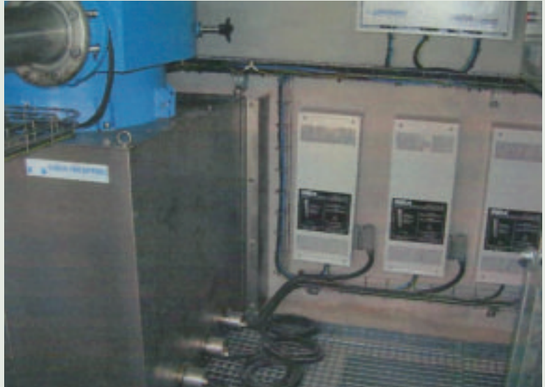
Figura 6 Resistencias refrigeradas por agua de salida y conectadas a unidades de control
