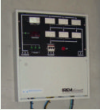
Figura 5. Cuadro eléctrico de control
