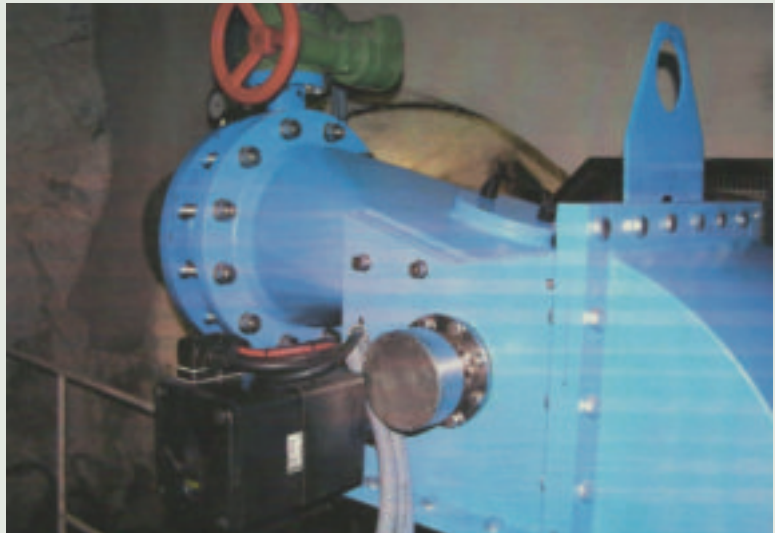
Figura 3. Grupo turbina Banki-generator
