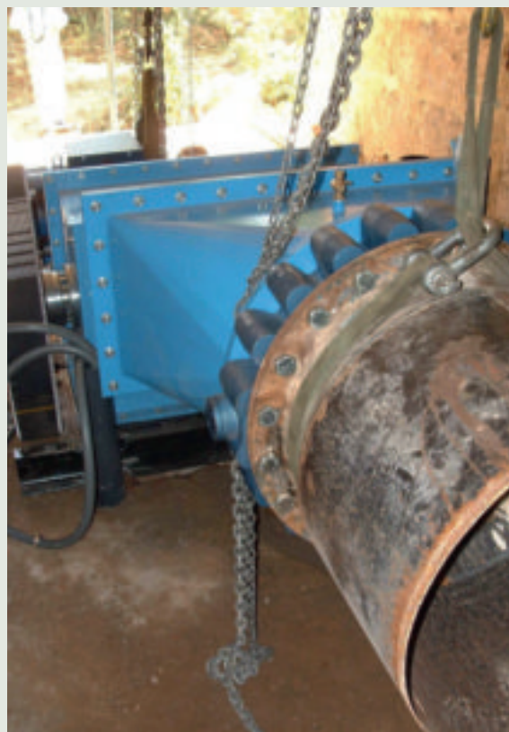
Figura 12. Acoplamiento de tubería de carga a turbina
